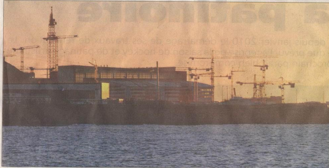
La centrale de Flamanville étant en bord de mer, Jacques Foos propose d'installer les diesels de secours en haut de la falaise afin de se prémunir de toute vague énorme.
